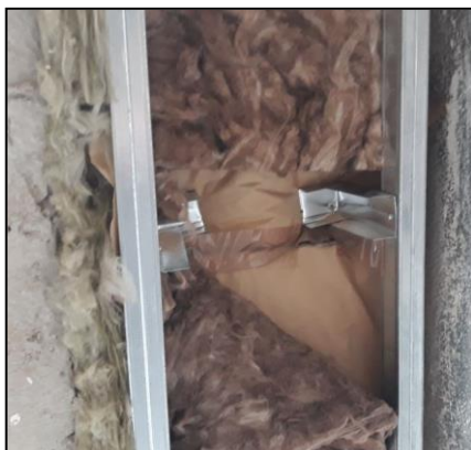
Fig. 8: Colocación del aislamiento en un trasdosado mediante la disposición de dos paneles de lana mineral. La barrera de vapor se ha puesto indebidamente entre esos dos paneles.
