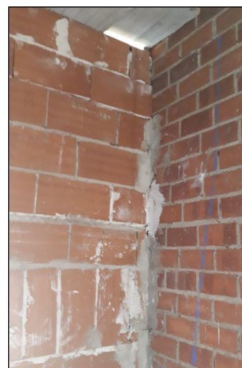
Fig. 3: La falta de enjarje puede ser motivo de fisuraciones. El encuentro entre ladrillos de distinto formato y características aumenta ese riesgo. En la imagen se aprecian trabas defectuosas y la colocación de algunos LHD en sentido vertical.
