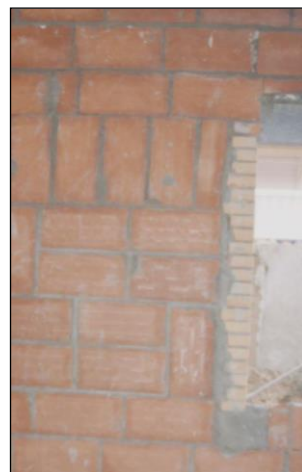
Fig. 4: Orientación desigual y errónea de las piezas dentro de las hiladas, mala horizontalidad de algunos tendeles y falta de traba con los ladrillos de la jamba.
