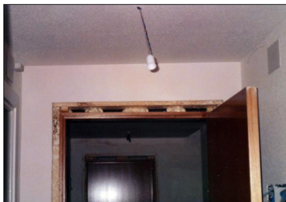
Fig. 1: Acuñaado entre el marco de una puerta y su precerco
