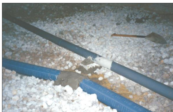
Fig.2: Redes de saneamiento y de drenaje (con encuentro incorrecto)
