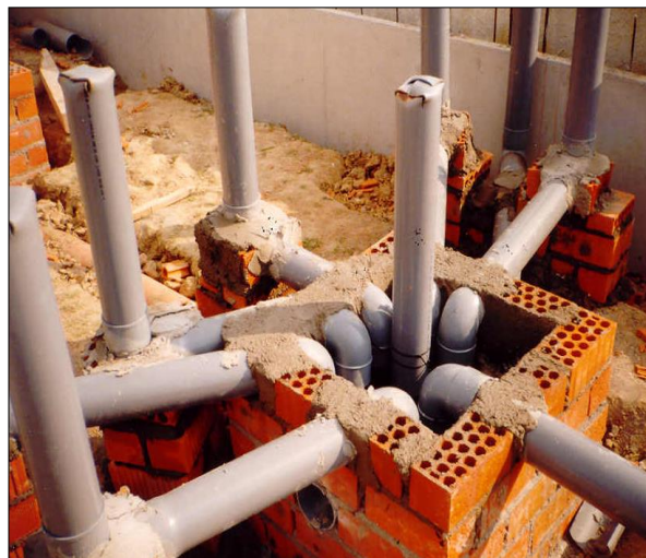
Fig. 5: Acumulación excesiva de tuberías por una falta de previsión en proyecto para el correcto cálculo de la red
