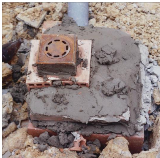
Fig. 4: Incorrecto diseño y ejecución de un sumidero de patio sobre una arqueta
