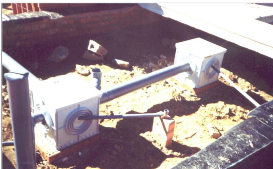
Fig. 8: Red de saneamiento bajo forjado sanitario realizada con arquetas prefabricadas y tuberías de PVC de pared lisa. Se observa que los apoyos están mal concebidos y no son suficientes.
