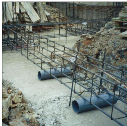
Fig. 7: Disposición de la red de saneamiento por debajo de las riostras, con colocación de pasatubos antes del hormigonado
