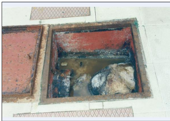
Fig. 1: Rotura de sifón (codo PVC) por entrape en este punto
