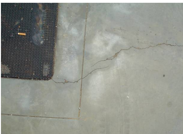
Figura 9: Fisuración por deficiente diseño de juntas o incorrecta ejecución
