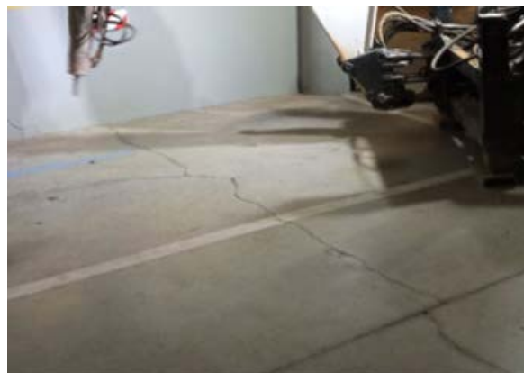
Figura 2: Fisuraciones en solera de hormigón
