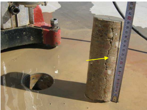
Figura 5. Fisura en solera Testigo de hormigón
