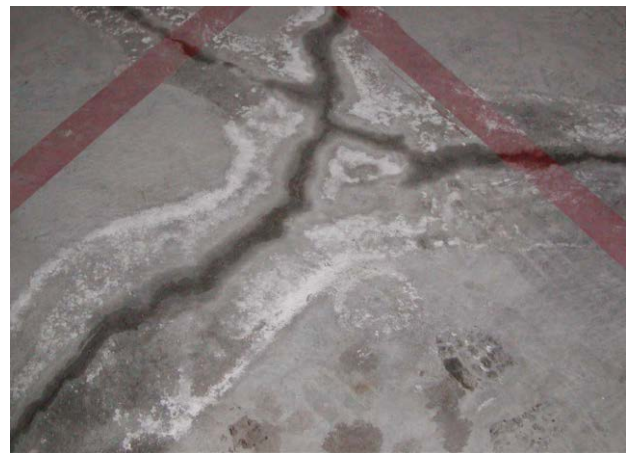
Figura 8. Humedades de filtración por fisuras en solera. Eflorescencias
