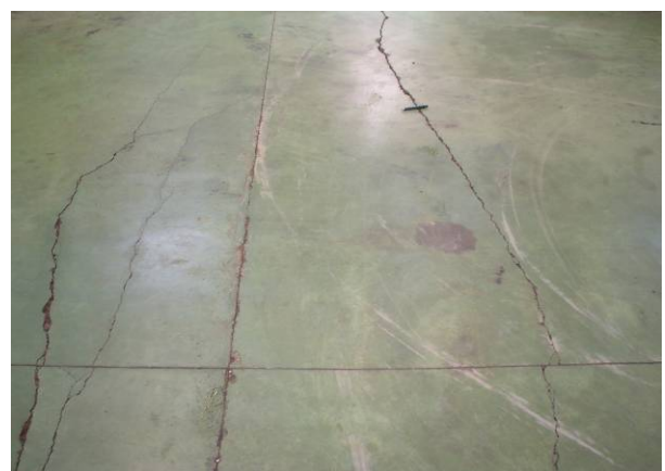
Figura 10. Pérdida de apoyo localizado en la base. Suelos inadecuados o deficiente compactación
