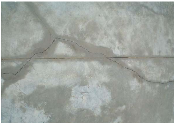
Figura 3: Fisuraciones de retracción en solera de hormigón
