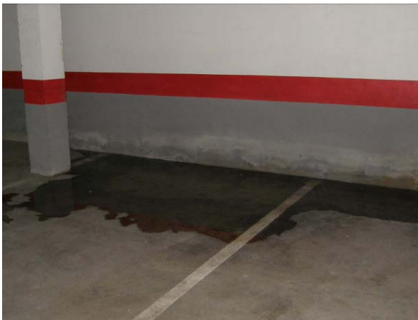
Figura 7: Filtración de agua por el encuentro entre la solera y el muro de contención.
