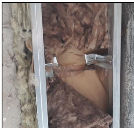
Fig. 8: Colocación del aislamiento en un trasdosado mediante la disposición de dos paneles de lana mineral. En la imagen se aprecia que la barrera de vapor se ha puesto indebidamente entre los dos paneles aislantes.
