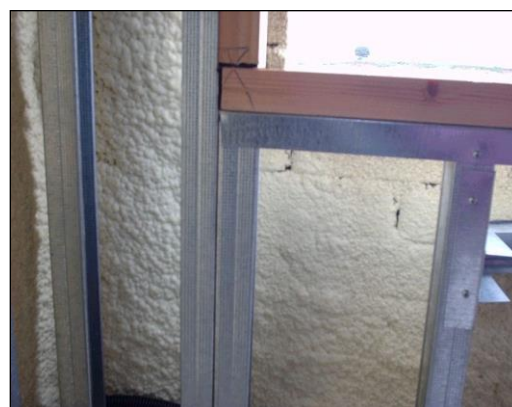
Fig. 10: Falta de realización de la patilla de doblado abrazando al montante de jamba, para envolver y reforzar la esquina anexa al cerco de madera de la ventana.
