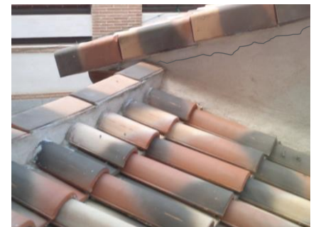
Fig. 4: Fisura característica en la parte superior del borde lateral de una cubierta inclinada (bajo pieza especial de remate)
