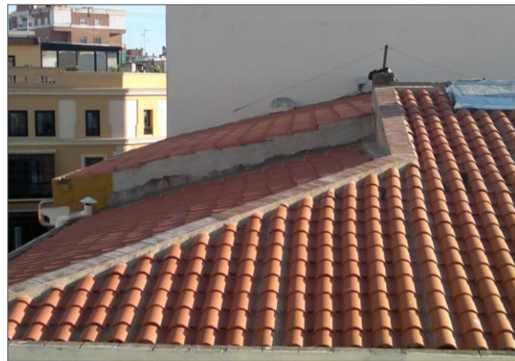
Fig. 1: Limatesa de una cubierta inclinada de teja cerámica
